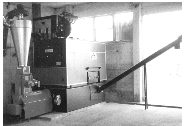
Abb. 4: 200 kW Kessel für Halmgut, mit Kesselbeschickung und Ascheabtragung. (auf einem Betrieb in Dänemark)
