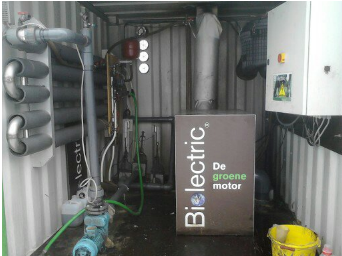
Photo 3: Mit dem Wärmetauscher (links) und der Umwälzpumpe (vorne links) wird die GÜlle auf 40°C erhitzt.
