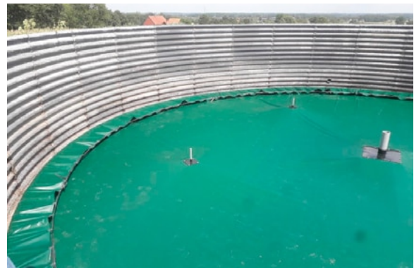
Güllelagerabdeckung mit Schwimmfolie (Quelle: Genap B.V.)
