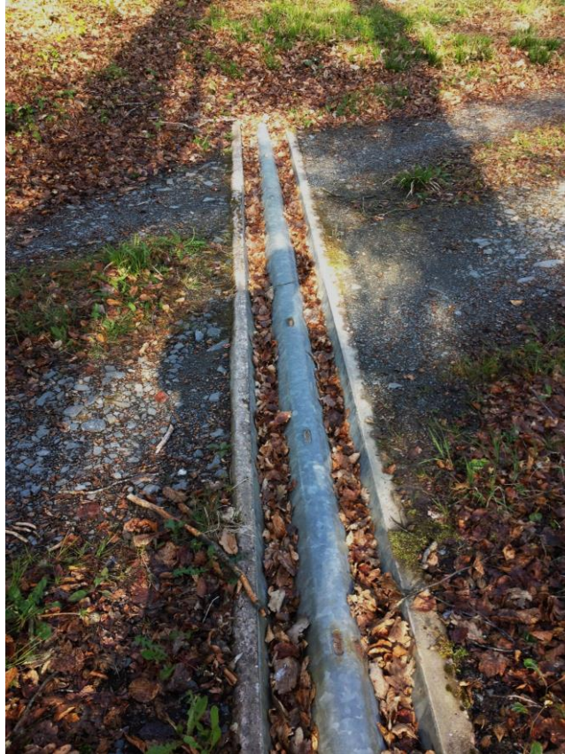
Abbildung 21: Querrinnen müssen regelmäßig auf ihre Durchlässigkeit hin überprüft werden und erschweren den Wegunterhalt
