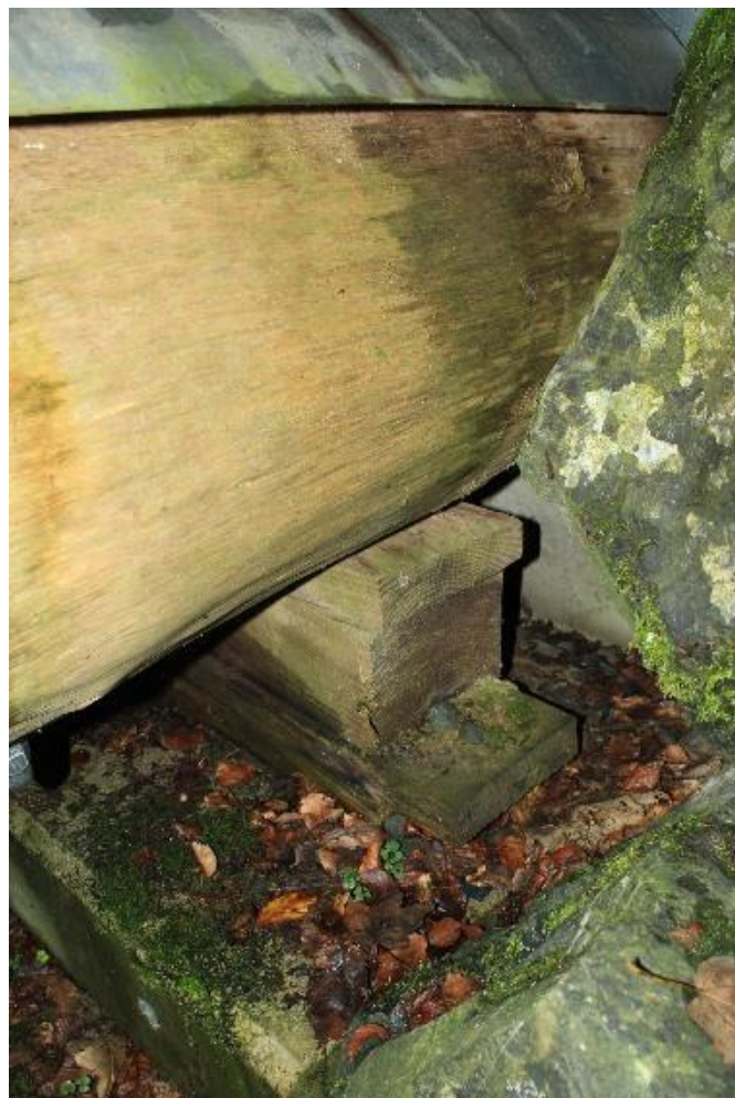
Abbildung 22: Widerlager einer der Brücken in Tarchamps. Feuchtigkeit hält sich dauerhaft aufgrund der eingewehten Laubstreu
